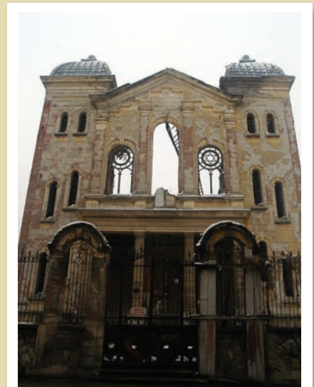
1907'de açılan Merkez Yahudi Havrası bakımsızlığa veyohyatrılığa daha fazla dayanamayıp 1997'de çökmüş. Bugün sadece cephesi ayakta.
