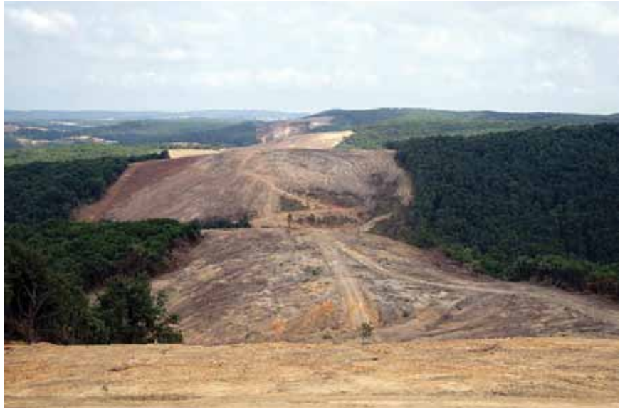
Üçüncü köprü'nün yeni yeni gündeme sokulduğu 2007’de Ulaştırma Bakanı Binali Yıldırım ‘3. Boğaz Köprüsü için çevreye zarar vermeyecek, çevre uğruna da ihtiyaçları gözardı etmeyeceğiz’ diyordu. Üstte köprü güzergahındaki ormanların son hali görülüyor.
