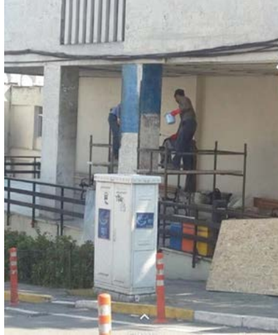
Öğrencilerin tepkisini yoğunlaştıran adımlardan biri de çatlakların kontrol yapılmadan aceleyle sıvanması oldu.
