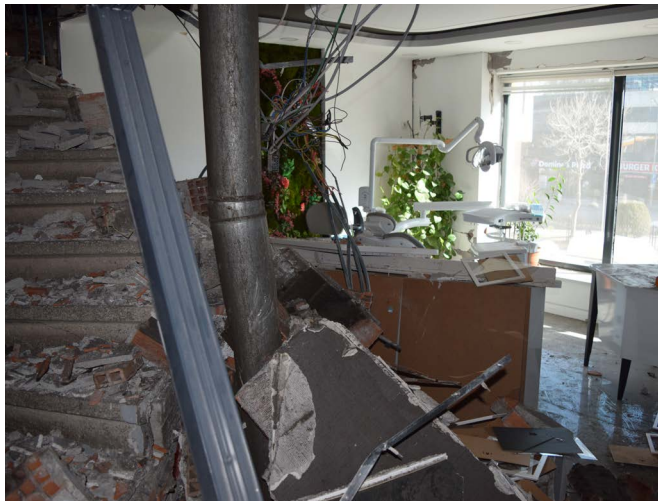
Adıyaman'da tümüyle göçmemiş binalarda bulunan kliniklerin birçoğu bu durumda.
