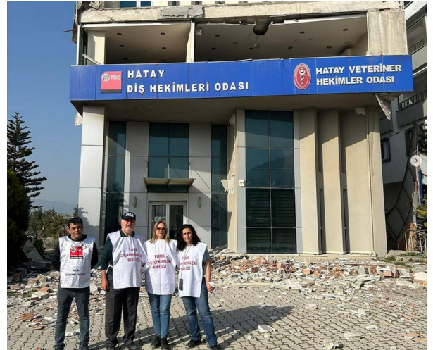
Hatay Dişhekimleri Odası binası da Adıyaman, Kahramanmaraş ve Malatya odalarımız gibi ağır hasarlı.
